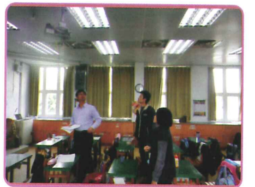
B、D棟部分教室天花板
